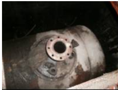
Figure 2 : Etat de la cuve avant pompage et démantèlement
